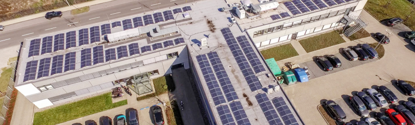
Bechtle Solingen setzt neben Photovoltaik auch auf Geothermie zur Energiegewinnung
